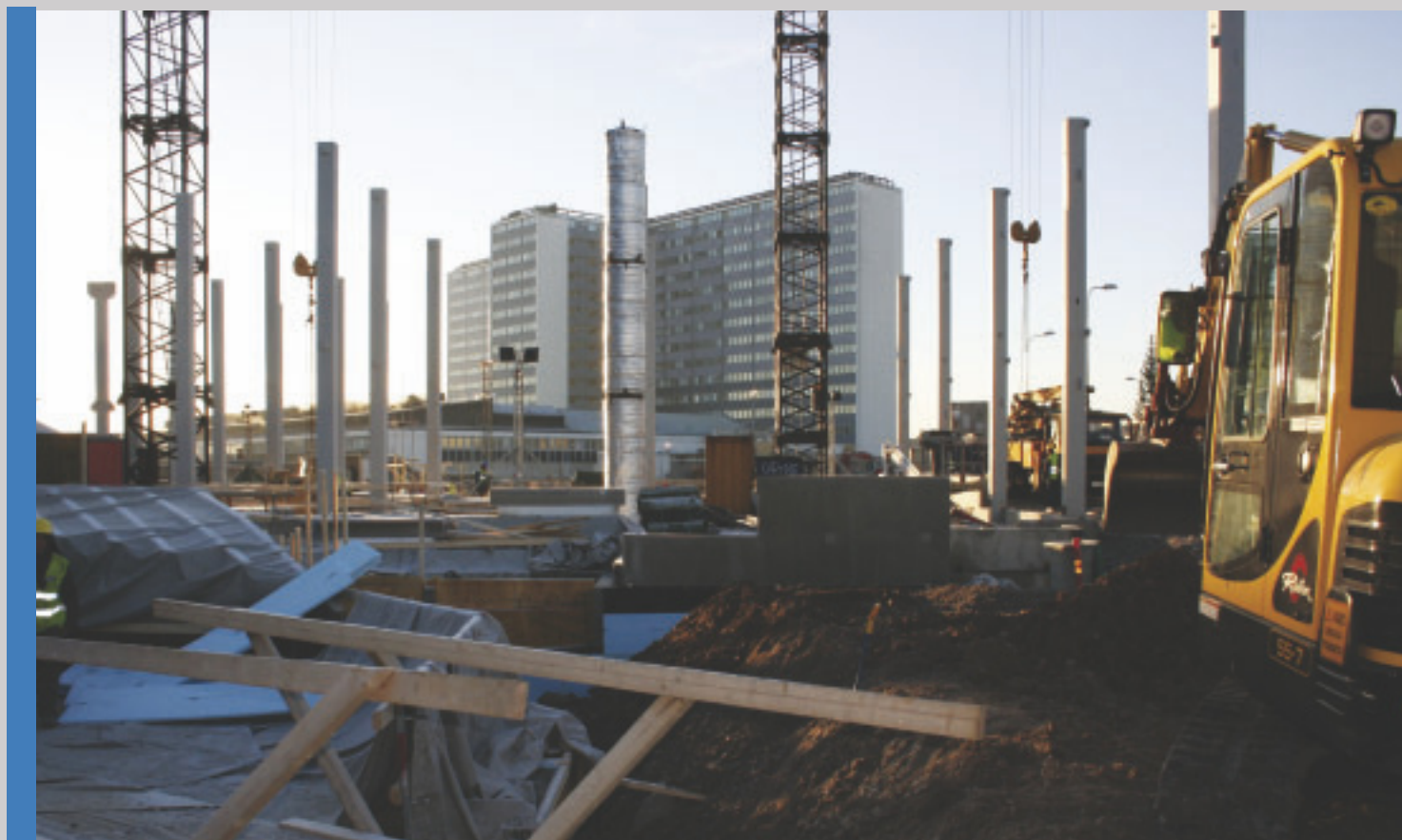
År 2007 påbörjades byggnadsarbetet av Triangelsjukhuset och fastigheterna för Helsingfors stads samdejourering i Mejlans.
